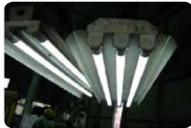
検査場に導入したLED照明 (年間10,800kWhの電力削減)
